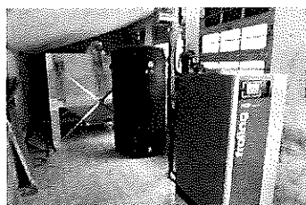
Une première installation livrée : site « La Cellette » du Centre hospitalier du Pays d'Eygurande.
