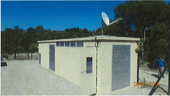
Poste de livraison électrique couleur ivoire clair
